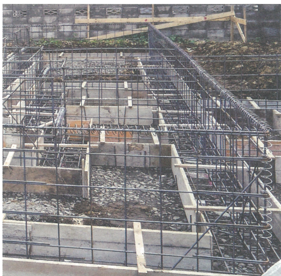
布基礎最上段の鉄筋や出隅の縦筋などに M&N コイルを取り付けている現場
